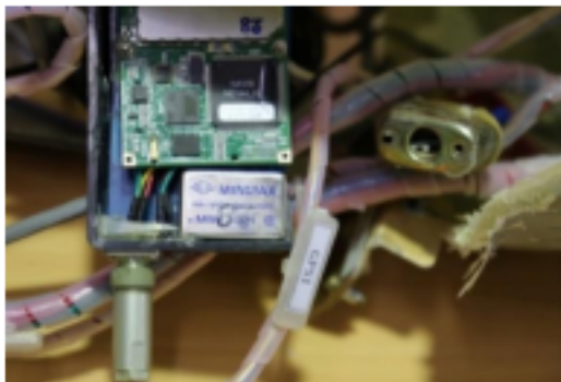
IMG-3029: DC Output Converter MIW 3021
